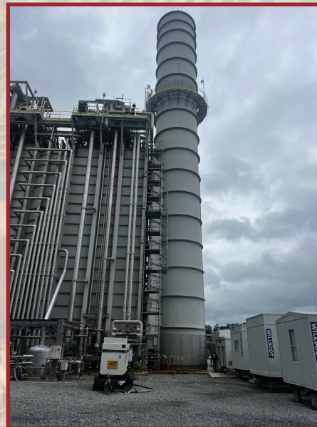
HRSG STACK EXPANSION JOINT
